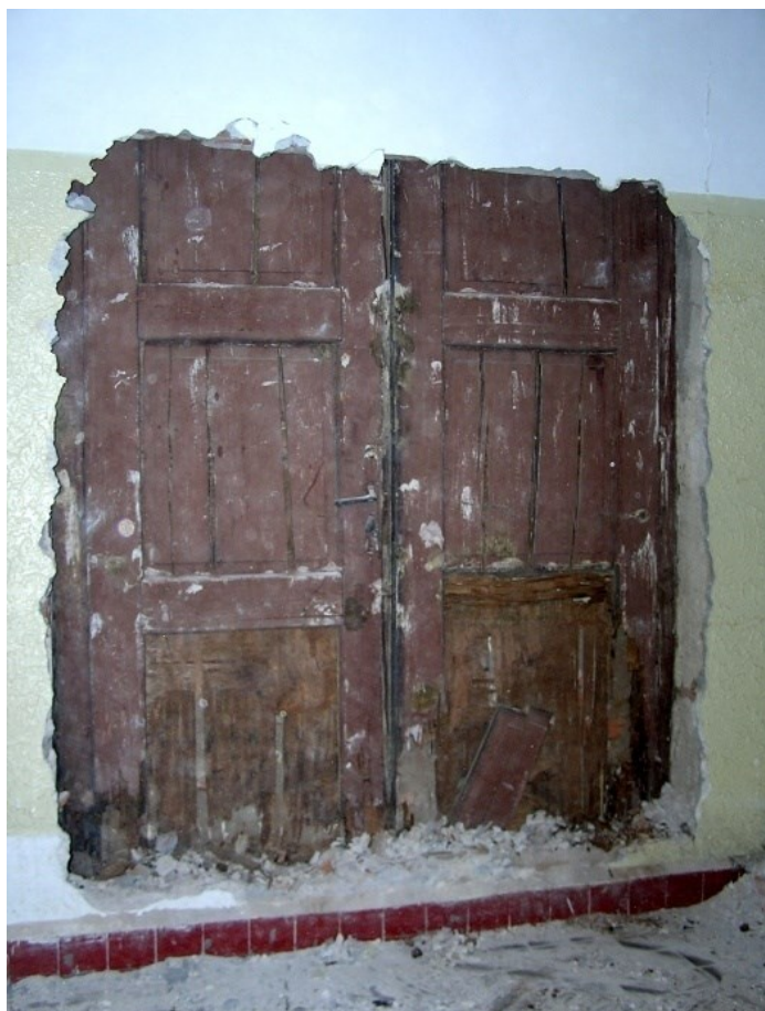
zazděné dveře – příčina vzniku výskytu dřevomorky 2. 7. 2007
