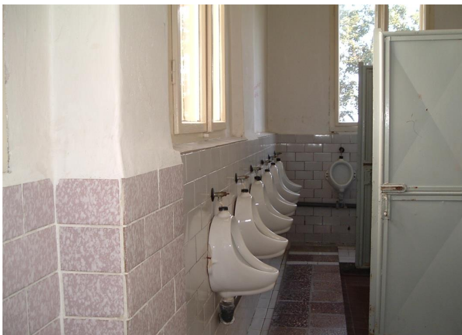
nevyhovující toalety na ZŠ Masarykovo náměstí
